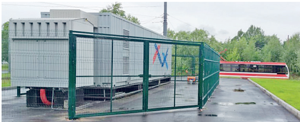
Модульная тяговая подстанция № 91
